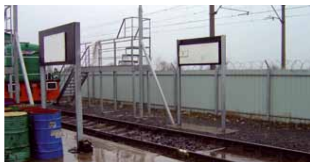
Kolejowe bramki dozymetryczne mierzące poziom radiacji eksportowanego złomu.
