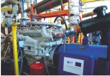
Agregat prądotwórczy wykorzystujący jako paliwo metan.
